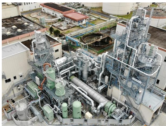
設備全景写真
