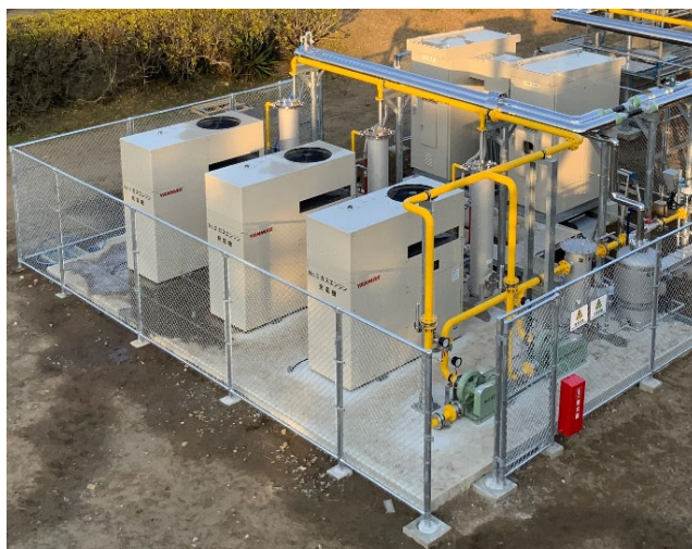
消化ガス発電設備
